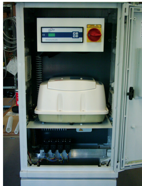
Innenansicht mit Steuerung, Verdichter LA 120 und Ventilanschlüssen
